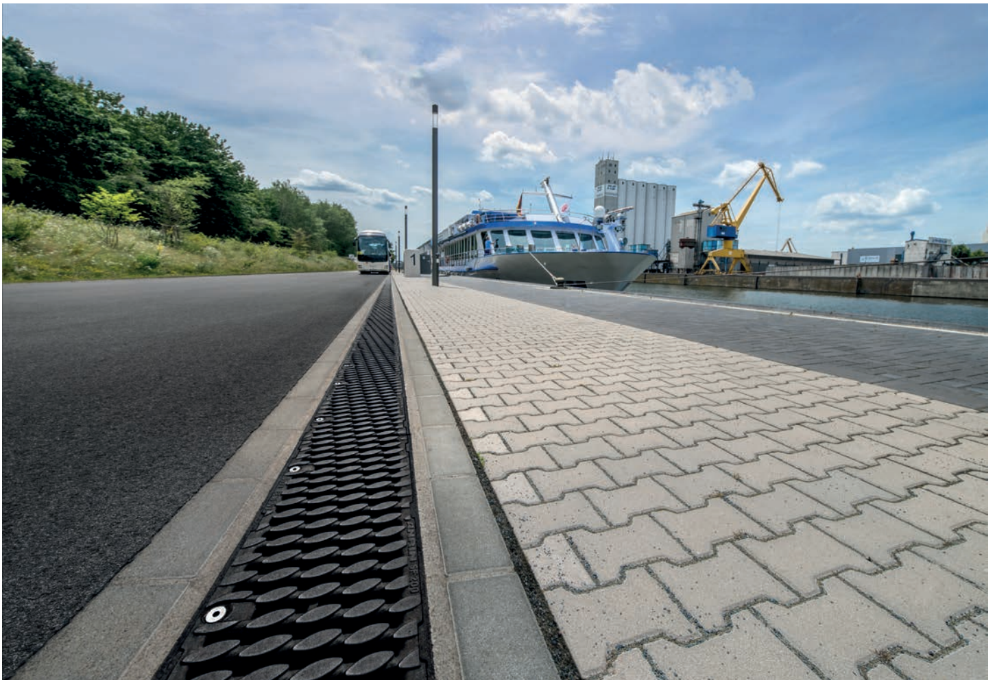
Caniveaux pour charges lourdes dans le port de navigation de passagers de Nuremberg
